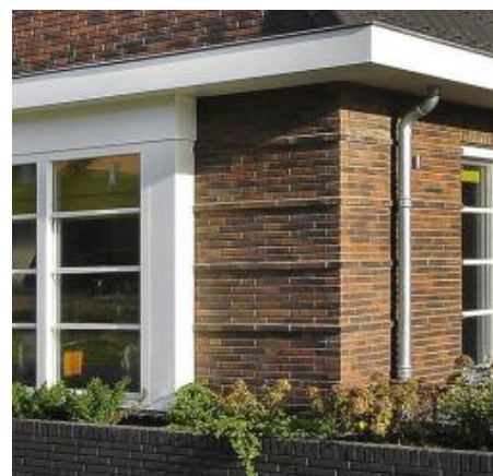
Horizontale belijning in metselwerk
